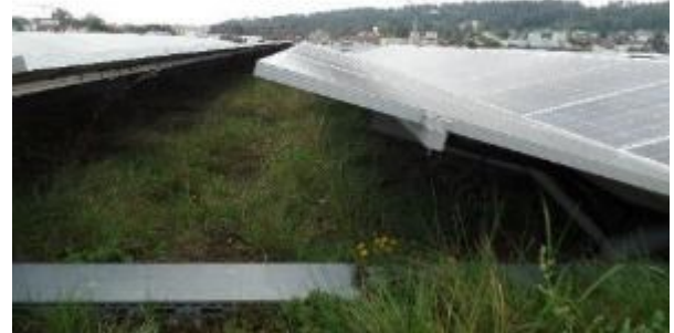
Kombinationen extensives Gründach mit PV/ Fotos Bodensee-Stiftung
